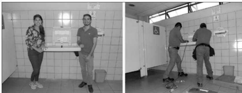
Figura 15. Instalación de cambiadores. A la izquierda, Fiorella Barrantes Barrantes y Carlos Andrés Venegas Elizondo, representantes de la Comisión de Asuntos Estudiantiles
